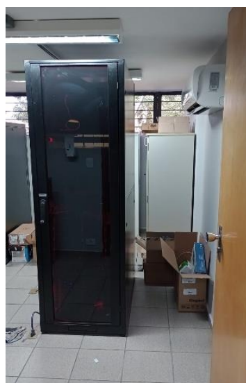
Data Center (antiga sala de Telefonista)
