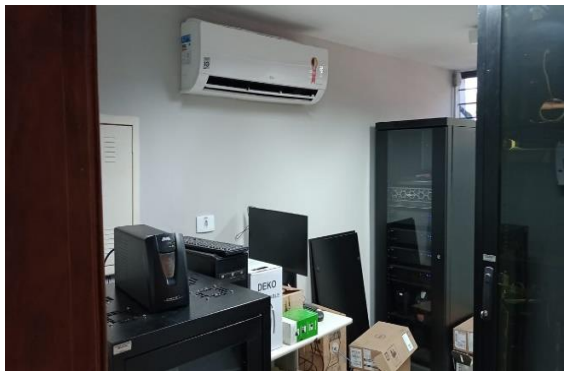
Data Center (antiga sala de Telefonista)
