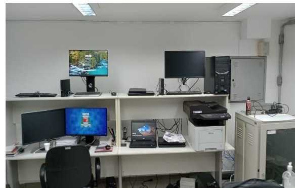
Sala de TI
