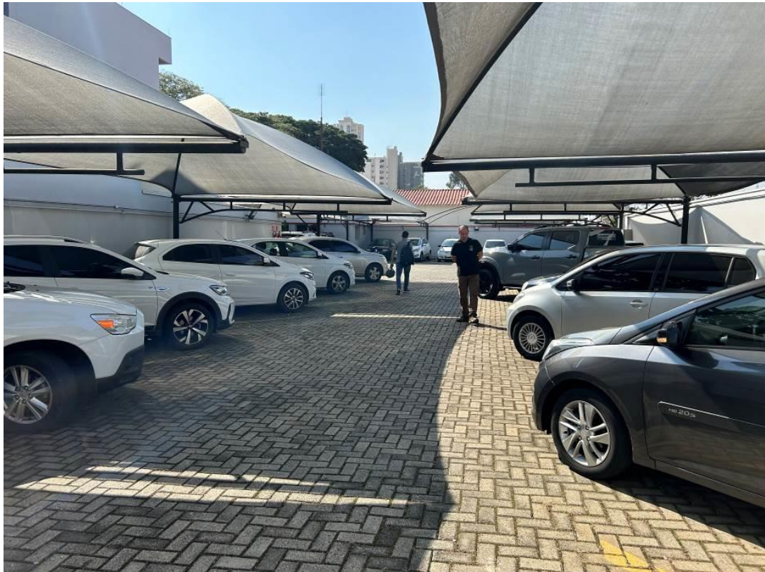
Foto 17: Vista do estacionamento descoberto (a reformar)
